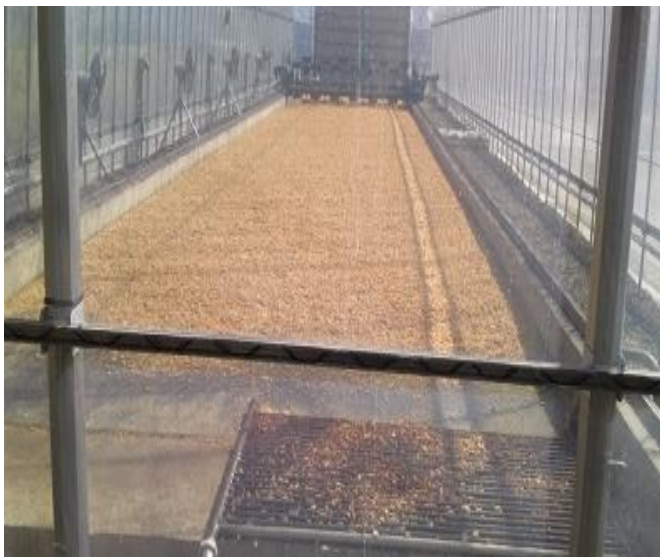
●プレートコイル設置状況
